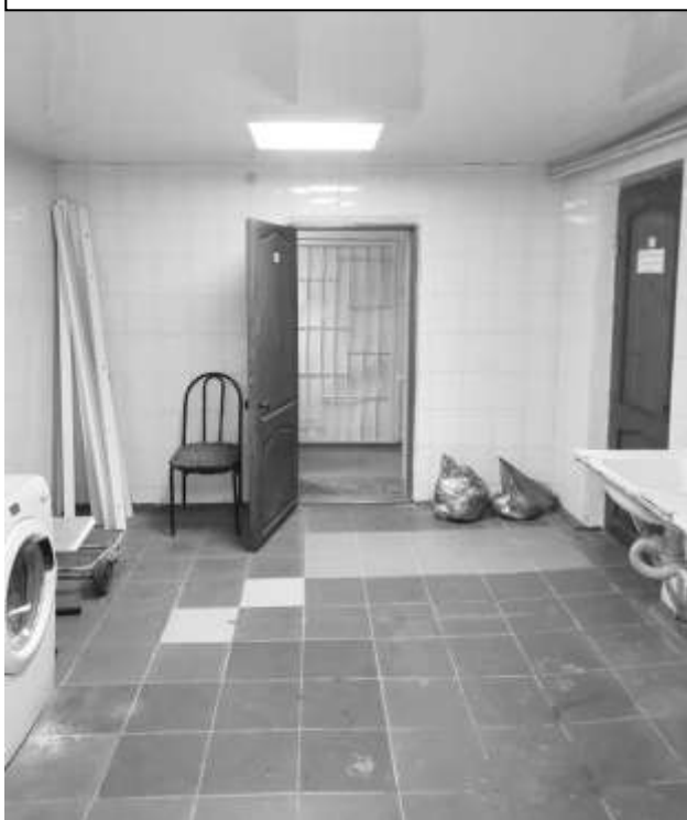
Фото 27 – Умывальники I этаж
