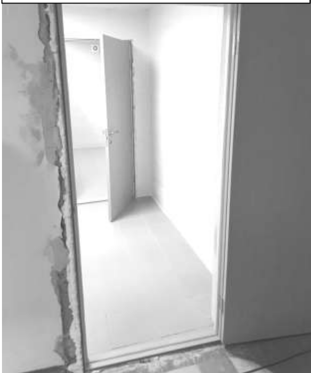
Фото 61 – Санузел IV этаж
