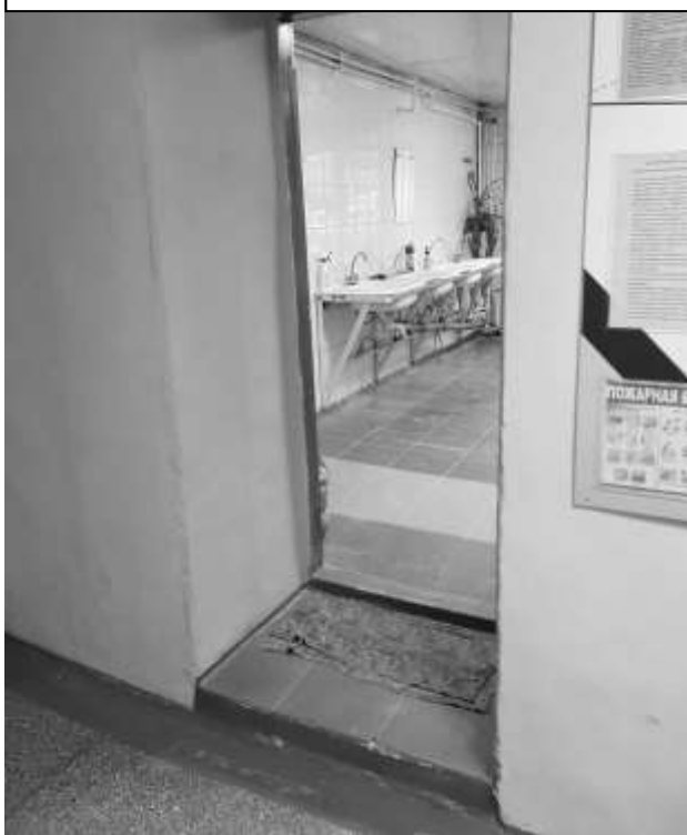
Фото 23 – Умывальники I этаж
