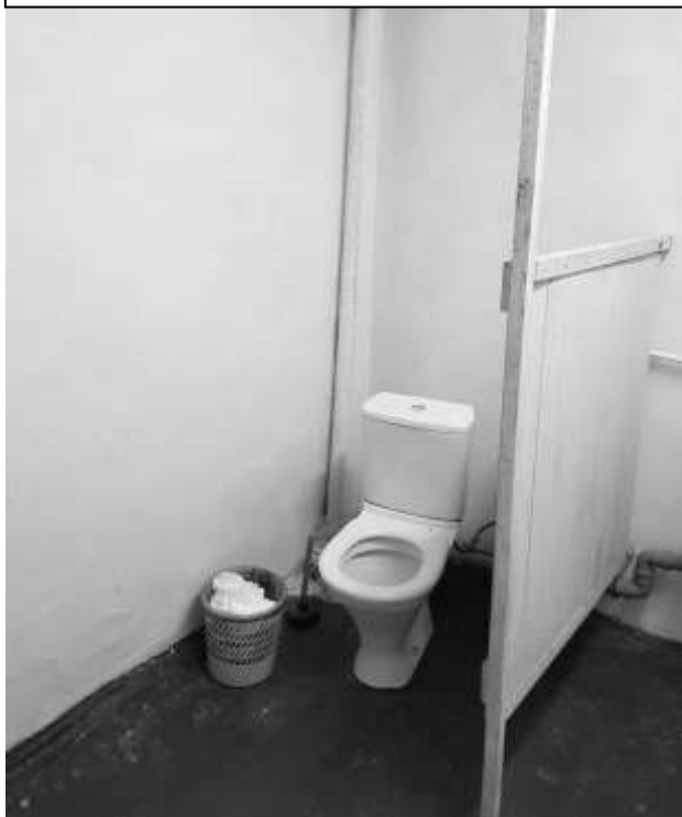
Фото 29 – Санузел I этаж
